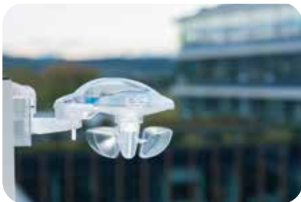
Die installierte LUXORliving Wetterstation auf dem Dach erfasst Daten zu Wind, Regen und Sonnenstand und steuert die Jalousien je nach Wetterlage.
