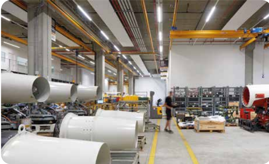
TECTON im Industriebereich bei Techno Alpin. ©Jürgen Eheim
